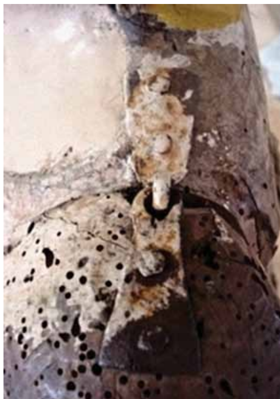
Deterioro producido por la presencia de xilófagos.
